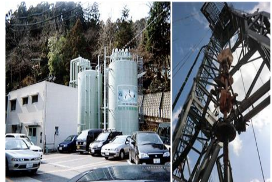
温泉掘削および 温泉集中管理システム
