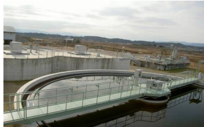
下水（反応槽・最終沈殿池設備）
