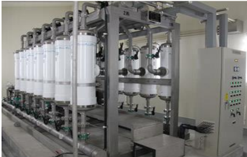
上水（膜ろ過施設）
