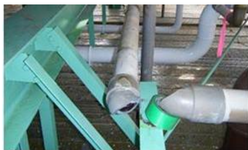
応力集中による破損
