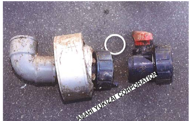
し尿の気化による破損
