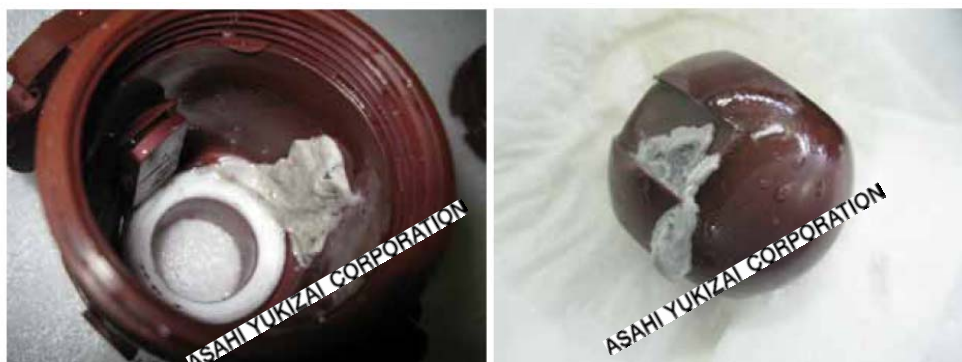
ボールバルブ内に異物が堆積し、作動不良を起こした事例
