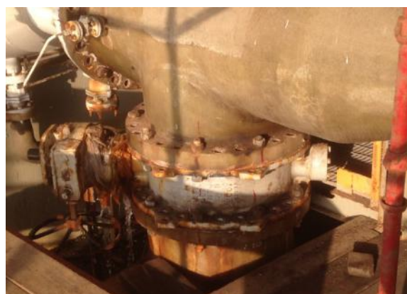
写真 5 外部漏れを起こす金属バルブ
