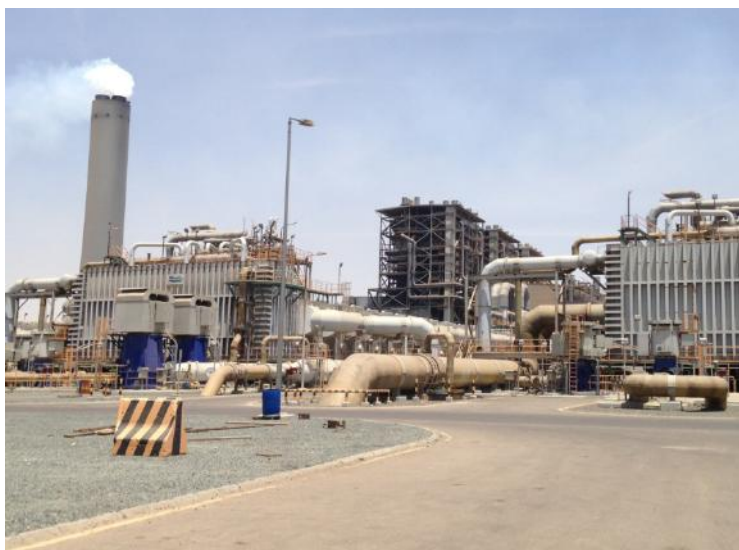
写真 4 中東の海水淡水化装置
