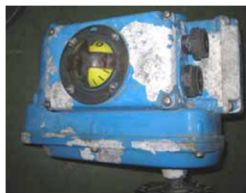
電動式駆動部の腐食状況
