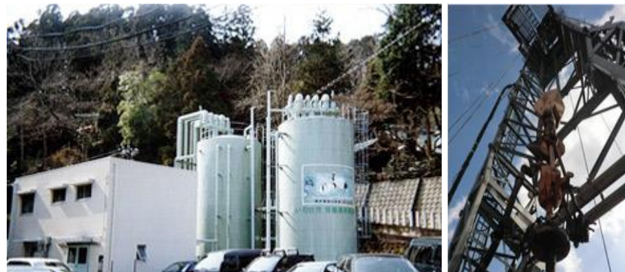
温泉掘削および温泉集中管理システム
