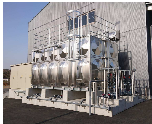
排水処理施設
