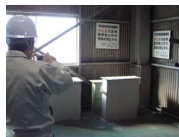
管材製造所での保管状態
