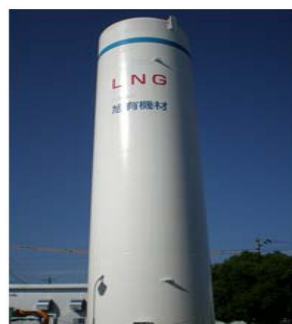
愛知工場に設置されたLNGタンク
